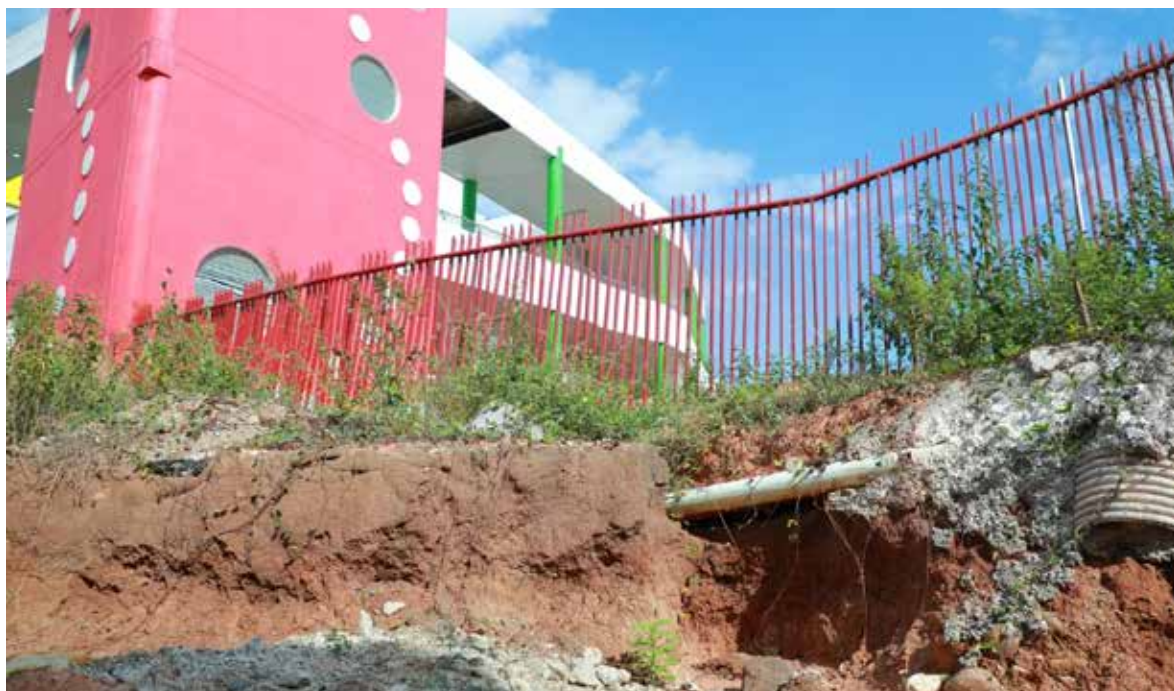
El megacolegio Rodrigo Lara es otra de las instituciones que presenta problemas de infraestructura.
